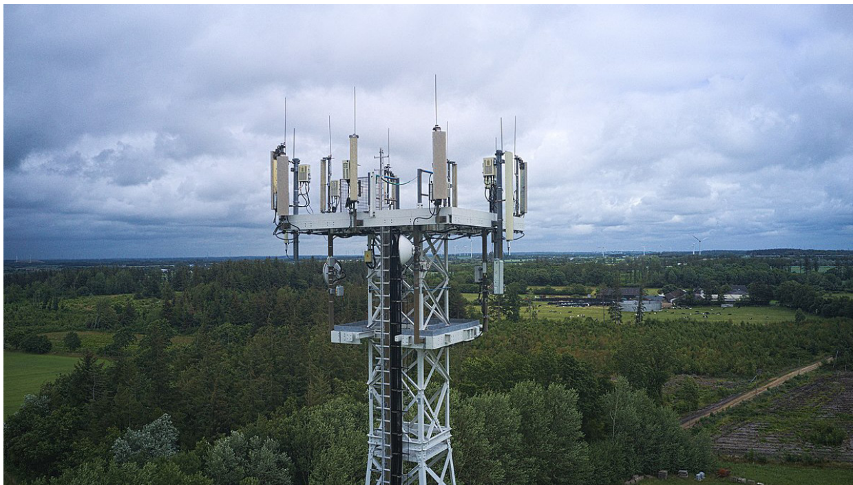
INSTALACJA INFRASTRUKTURY 5G FIRMY VODAFONE W NIEMCZECH. ŹRÓDŁO: WIKIMEDIA COMMONS
